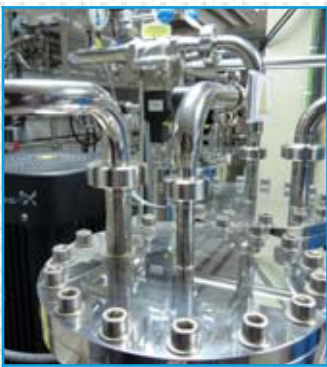
Une installation tout en inox médical a été installée au sous-sol pour traiter l'eau. © AG
